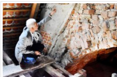
Spannungsrisse im Mauerwerk des Gewölbes: Architekt Torsten Ewers kennt die Schwachstellen der Marienkirche. ©
