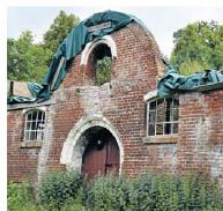
Der historische Pferdestall in Rixdorf, der nach einem Blitzschlag vor rund drei Jahren niederbrannte, wird dank eines Zuschusses von 200 000 Euro aus Mitteln des Denkmalschutzes wieder aufgebaut. FOTO: PTS
